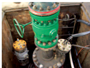
Tête d'un puits de forage géothermique.
